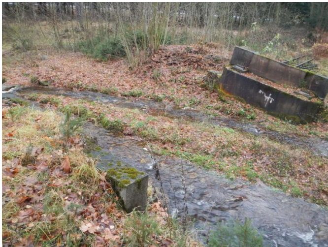
Durch die Flut 2002 zerstörtes Brückenbauwerk zwischen Schmiedeberg und Kipsdorf
